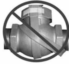
C.) Instalación incorrecta: Cinta calentadora superpuesta sobre sí misma
